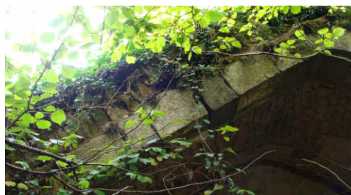
Les pierres disjointées de la voûte
